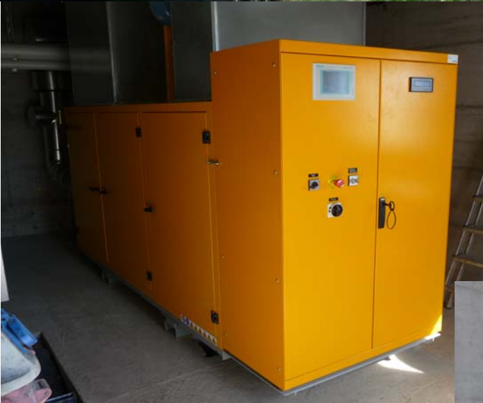
Blockheizkraftwerk (Gasmotor mit Generator)
